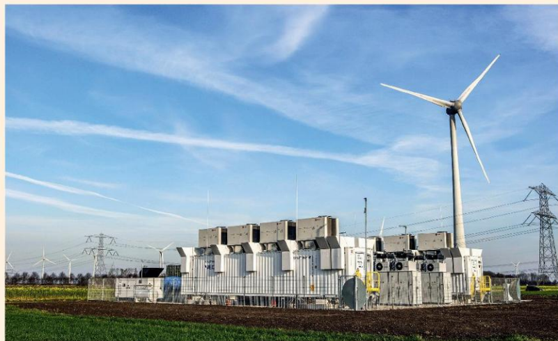
GIGA Storage wil in ons land meerdere grote batterijparken bouwen. Het baat al twee kleinere parken uit in het Nederlandse Lelystad.
